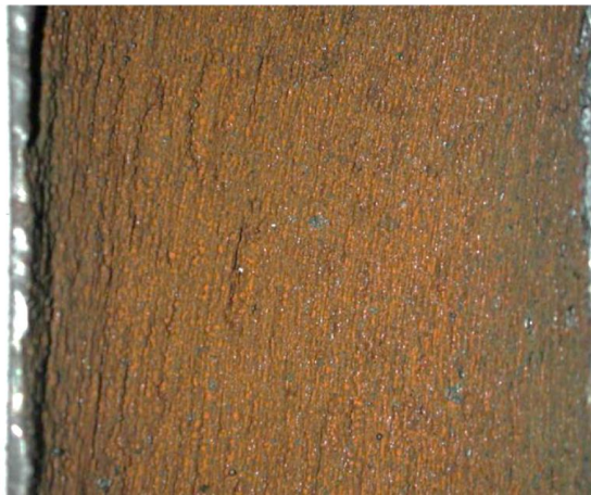
Slika 2.9. Primjer erozijske korozije unutar cijevi izrađene od ugljičnog čelika za skladištenje ukapljenog naftnog plina (uočava se karakteristična hrapava površina s nejednolikom debljinom) [2]
