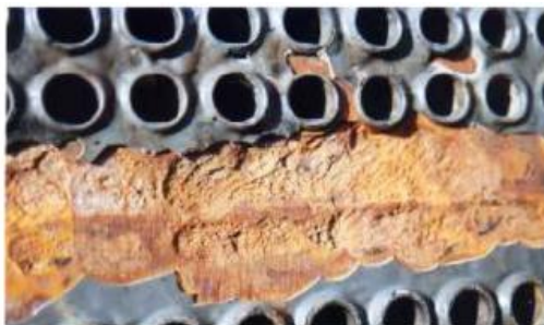
Slika 2.3. Prikaz galvanske korozije na čeličnom limu izazvan velikom katodnom području (admiralne brončane cijevi) i anodnog područja (ugljični čelik s epoxy prevlakom); sivo područje predstavlja neuspjeli epoksidni premaz, a narančasto područje predstavlja korodirani sloj lima [2]
