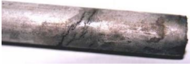
Slika 2.10. SCC korozija cijevi izrađene od nehrđajućeg čelika (SS 316) izložen atmosferi koji sadrži plinovitu klorovodičnu kiselinu [2]
