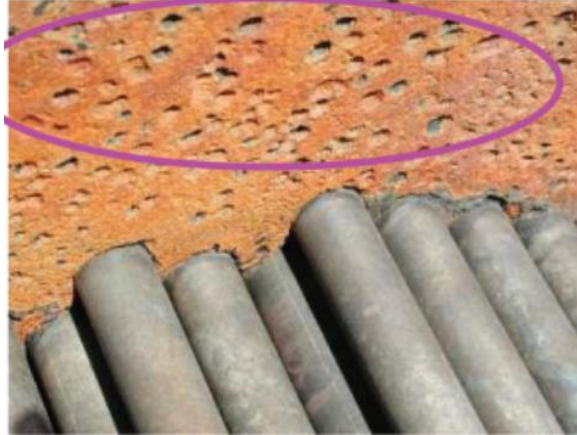
Slika 2.6. Jamičasta korozija (eng. pitting ) na ugljičnom čeliku izmjenjivača topline [1]
