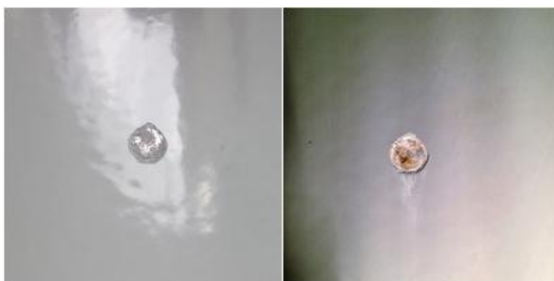
Slika 4.3. Izgled oštećenja sustava S2 promjera 6,5 mm prije i nakon izlaganja NaCl - u
