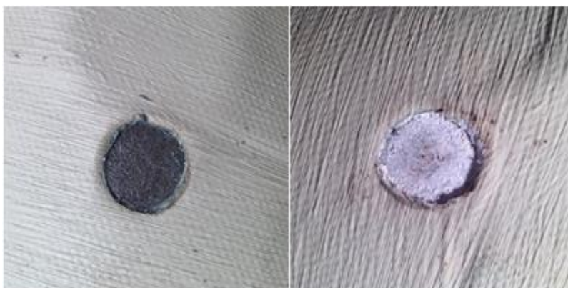
Slika 4.8. Izgled oštećenja sustava S4 promjera 13 mm prije i nakon izlaganja NaCl – u
