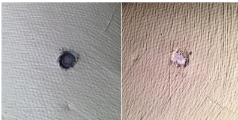
Slika 4.7. Izgled oštećenja sustava S4 promjera 6,5 mm prije i nakon izlaganja NaCl – u
