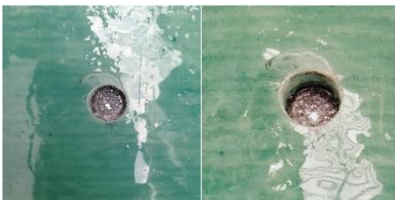
Slika 4.9. Izgled oštećenja sustava S5 promjera 6,5 mm prije i nakon izlaganja NaCl - u
