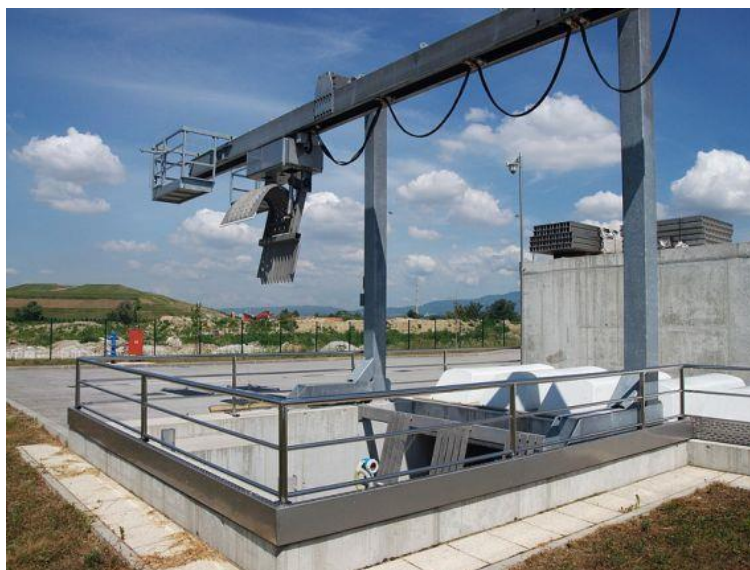
Slika 1. Pokretna rešetka na uređaju za mehaničku predobradu Zagrebačkih otpadnih voda [12]
