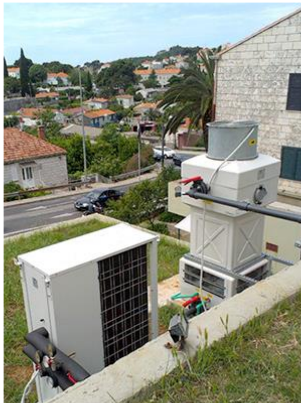
Slika 24. Dizalica topline i mokri rashladni toranj [41]
