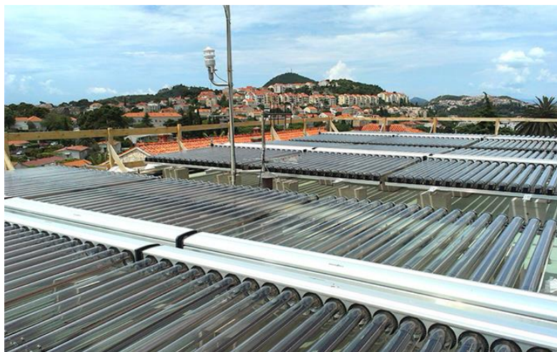
Slika 23. Polje solarnih vakuumskih kolektora površine 60 m 2 [40]
