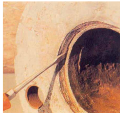
Slika 9. Korozija u cijevi izazvana morskom vodom [41].
