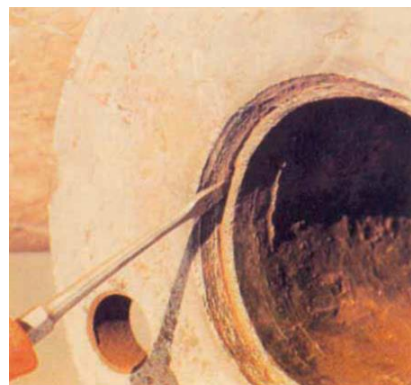
Slika 9. Korozija u cijevi izazvana morskom vodom [41].
