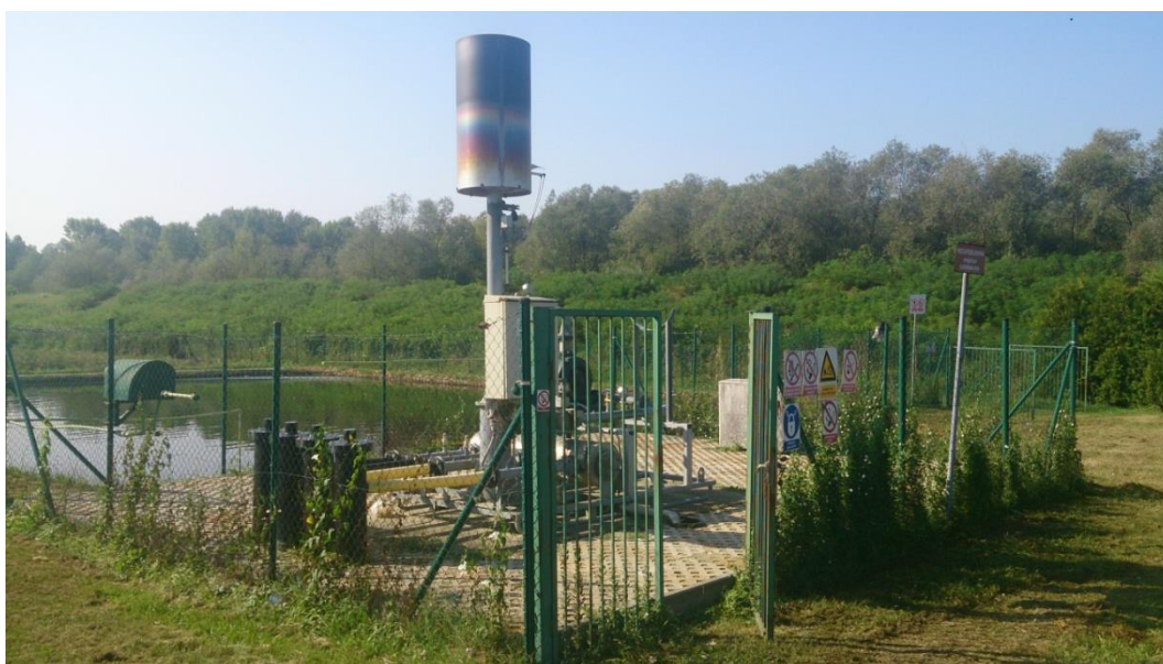
Slika 4.4. Plinsko-crpna stanica s bakljom za spaljivanje odlagališnog plina
