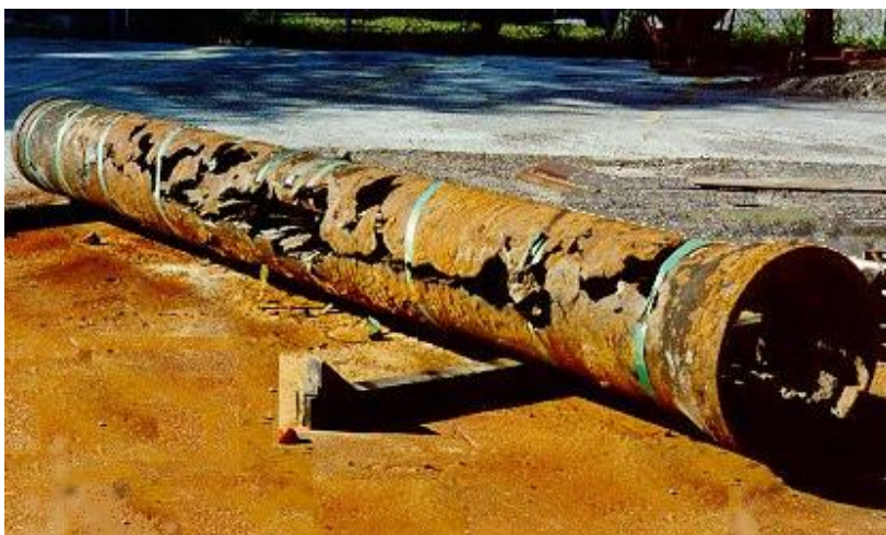
Slika 2.17. Utjecaj korozije na nezaštićenu cijev ( http://www.dontdig.com/plumbing/cast-iron-pipe-repair pristupio 15.5.2017)
