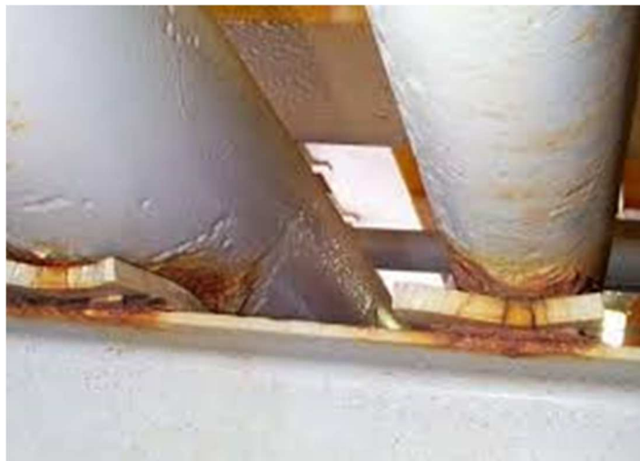
Slika 2.7. Primjer korozije u procjepima
