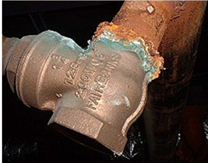
Slika 2.6. Primjer galvanske korozije na mjestu kontakta mjedi i čelika
