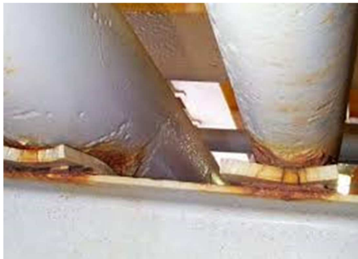
Slika 2.7. Primjer korozije u procjepima
