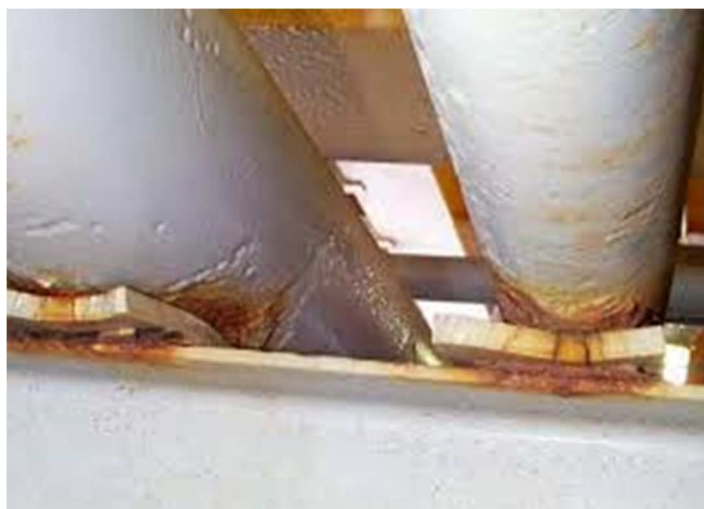
Slika 2.7. Primjer korozije u procjepima
