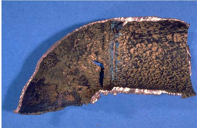
Slika 2.11. Primjer erozijske korozije na unutrašnjosti bakrene cijevi
