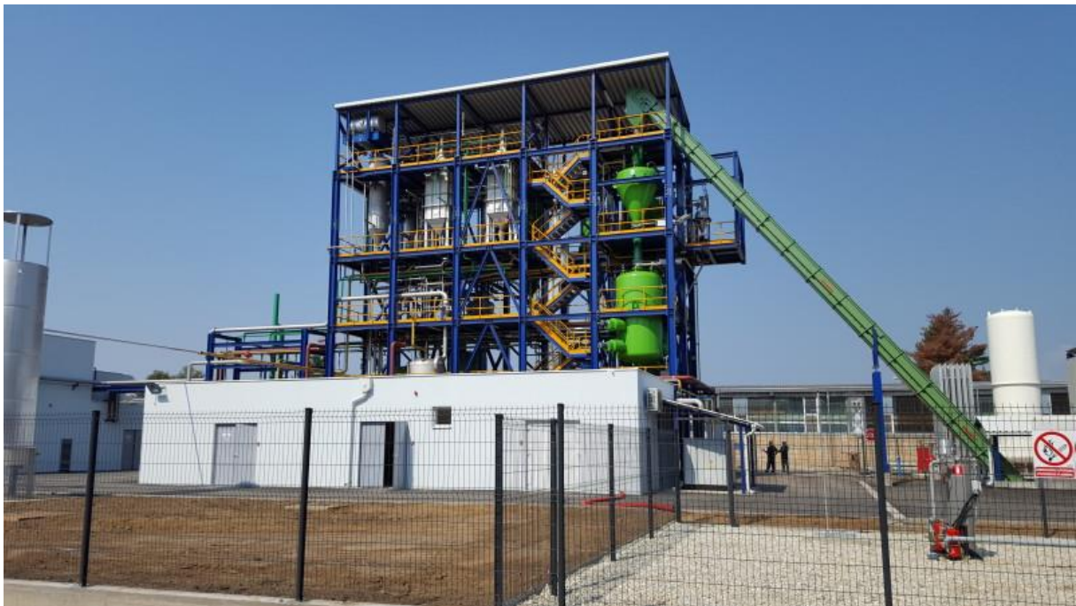
Slika 9. Postrojenje u Belišću; dio za rasplinjavanje [9].
