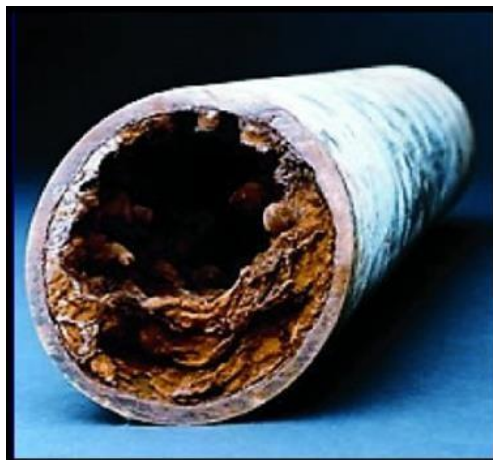
Slika 8. Primjer mikrobiološki izazvane korozije na cijev od nehrđajućeg čelika [15]
