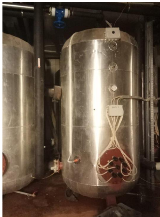
Slika 3-2: Bojler za toplu vodu
